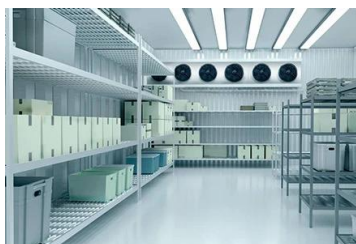
Monitoring des chambres froides
