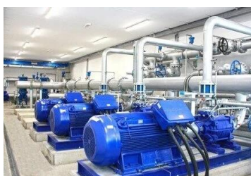
Télégestion des réseaux d'eau
