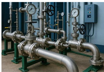
Surveillance des installations gazières
