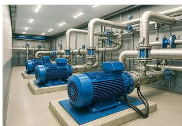
Télégestion des réseaux d'eau
